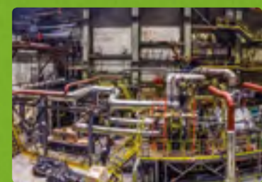
Испытательный стенд для паровых турбин
